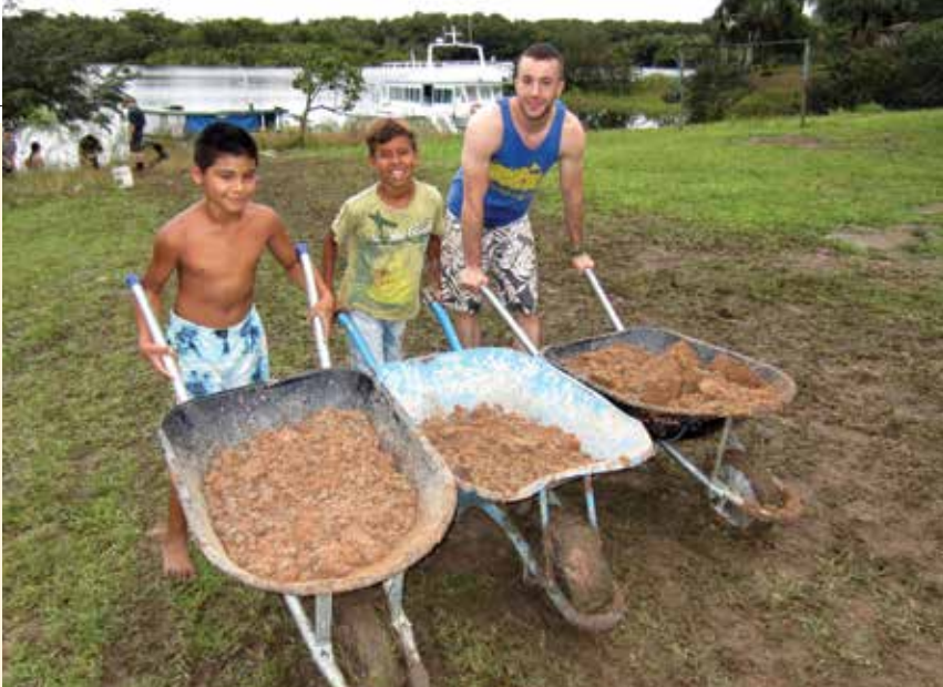
КОЛЕСА ПРОГРЕССА: Чад Латимер и его двое друзей управляют тремя тачками, которые были куплены для работ по заливке фундамента.
